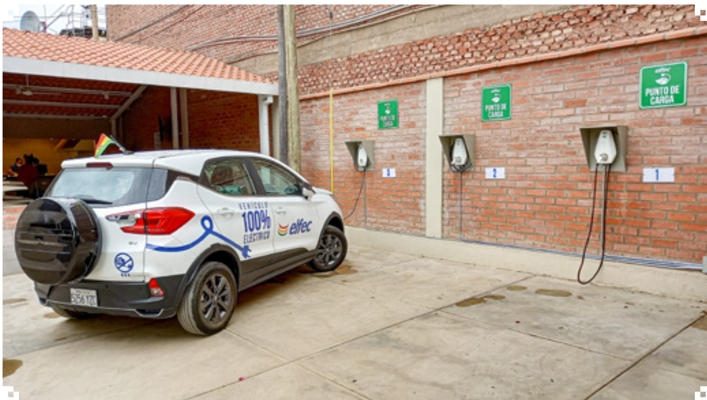
Movilidad eléctrica realiza una recarga de energía.
