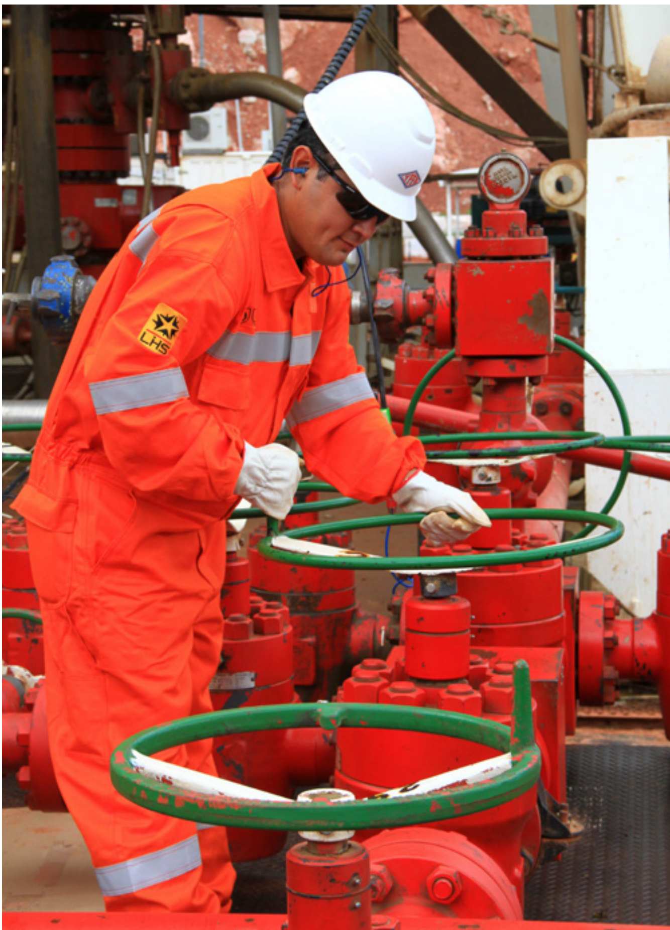
Operador en Pozo Margarita X7.
