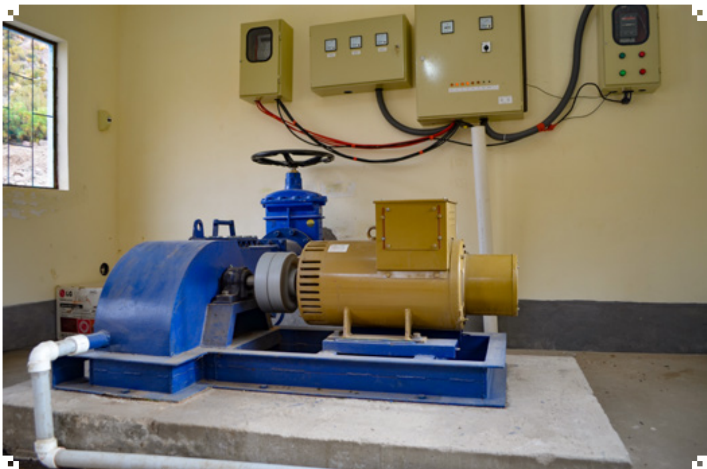
Microcentral hidroeléctrica que genera electricidad con una bajante de agua.
