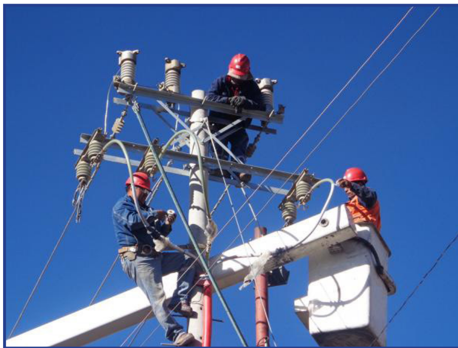
Instalación eléctrica. Foto: Cambio
